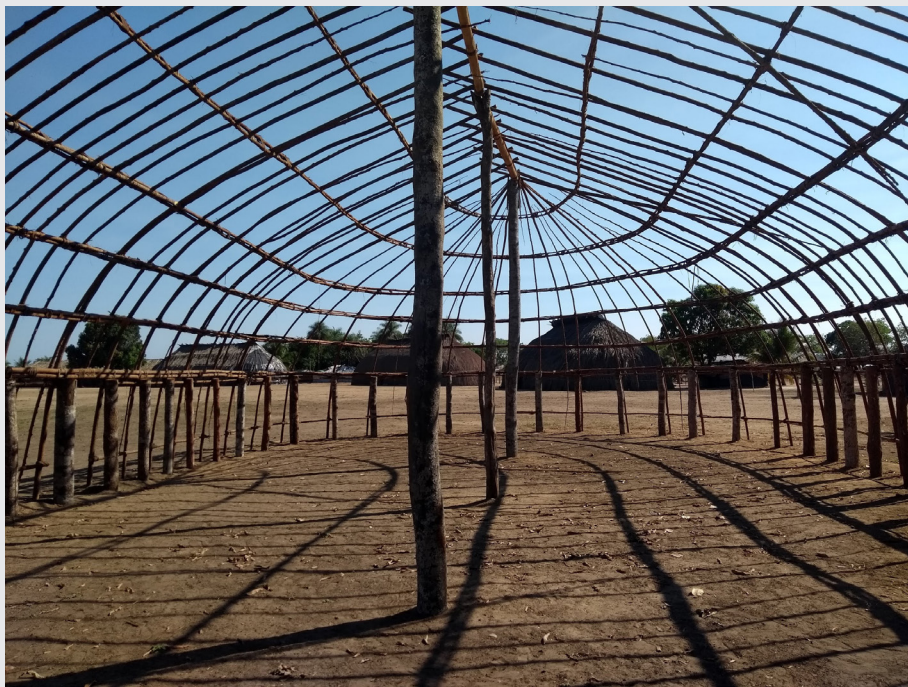
Figura 15. Casa “lagartixa”, em construção no período da oficina realizada para produção do Manual de arquitetura Kamayurá
